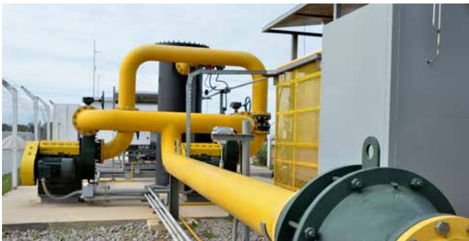
> Planta de captura de biogás en el Sitio de Disposición Final de Residuos. Foto: Artigas Pessio.
